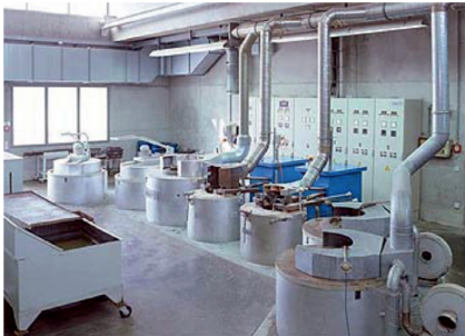
Bild 1: Elektrisch beheizte Salzbadanlage
